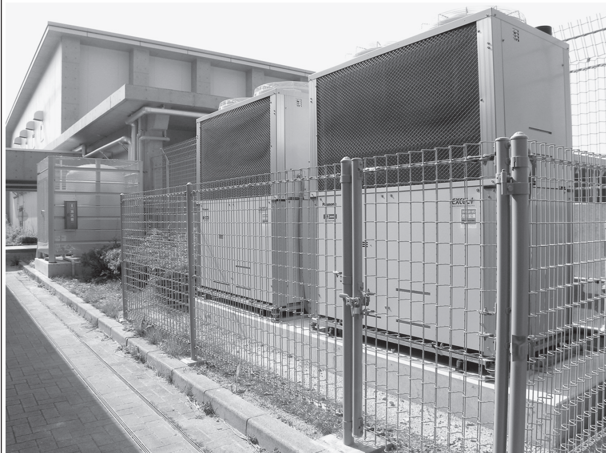
太宰府特別支援学校に設置したパナソニック製電源自立型GHP20馬力2台。左奥は980kgたて型バルク貯槽
